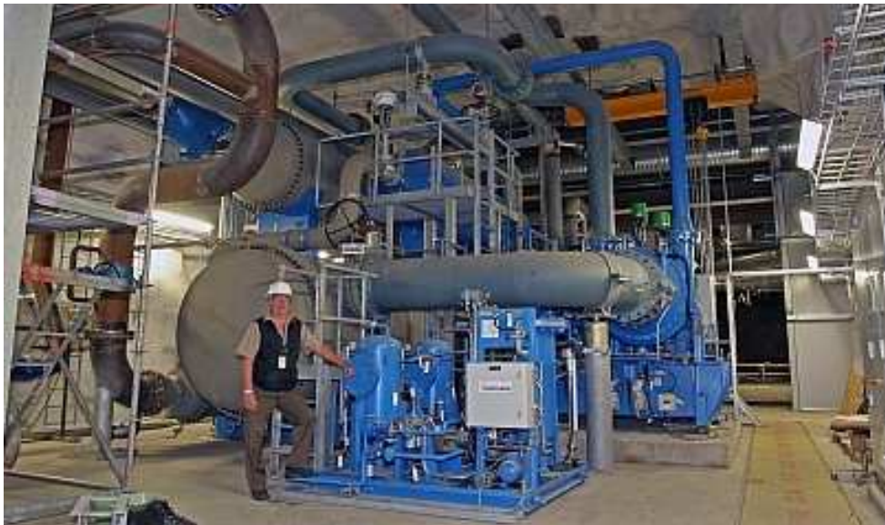
Figuur 49 - Warmtepomp in combinatie met warmtenet te Helsinki (bron: foto graaf onbekend)
